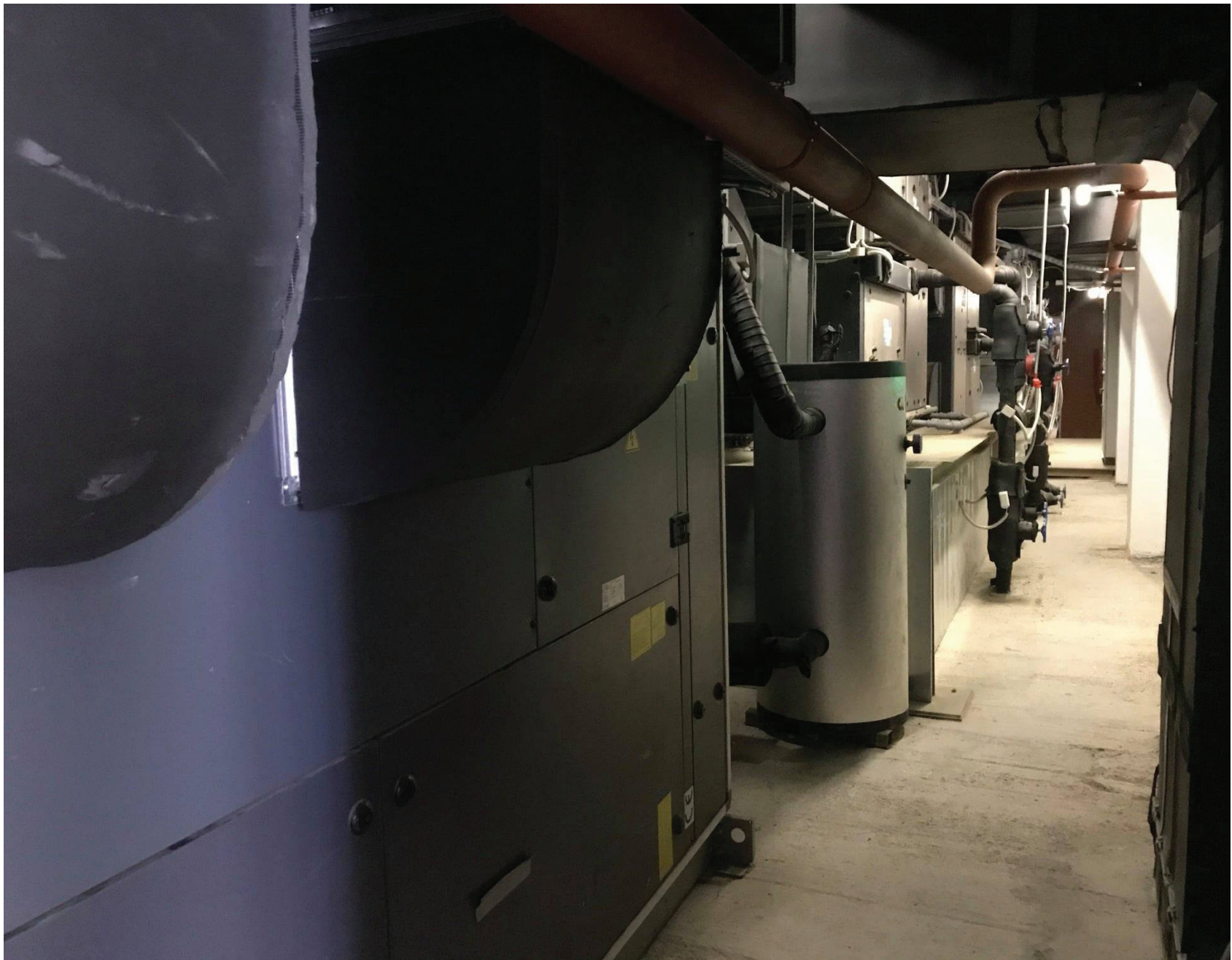
[POSTOJEĆE STANJE] Strojnica. Izdana je uporabna dozvola u 2019. godini.
