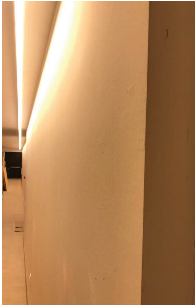
[POSTOJEĆE STANJE] Izlazni hodnik 01.10.2021. godine. Izdana je uporabna dozvola u 2019. godini.
